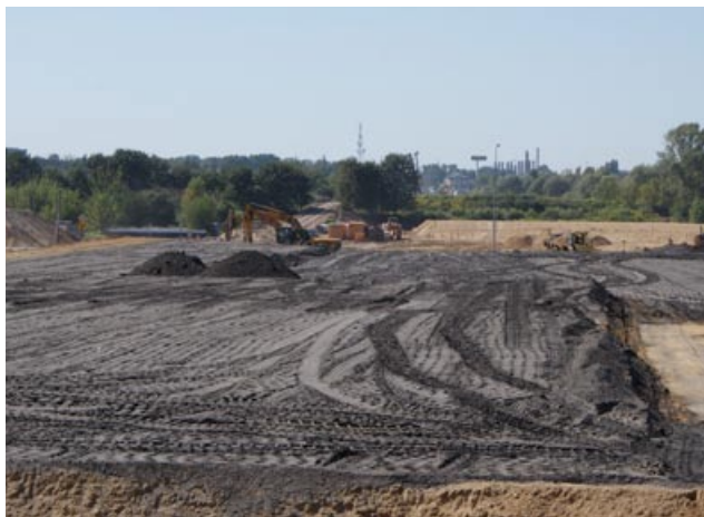
Most Północny w Warszawie – budowa nasypów z kruszywa z żużli paleniskowych UTEX-CEN
